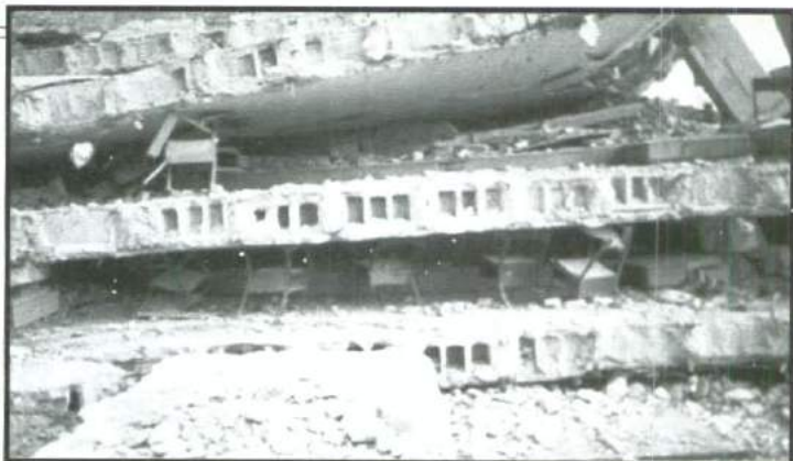
Figura 37: Esta foto fue tomada después del terremoto de 1985 en Méjico. Muestra que a pesar del colapso de los pisos, los escritorios servían como lugar de protección.
