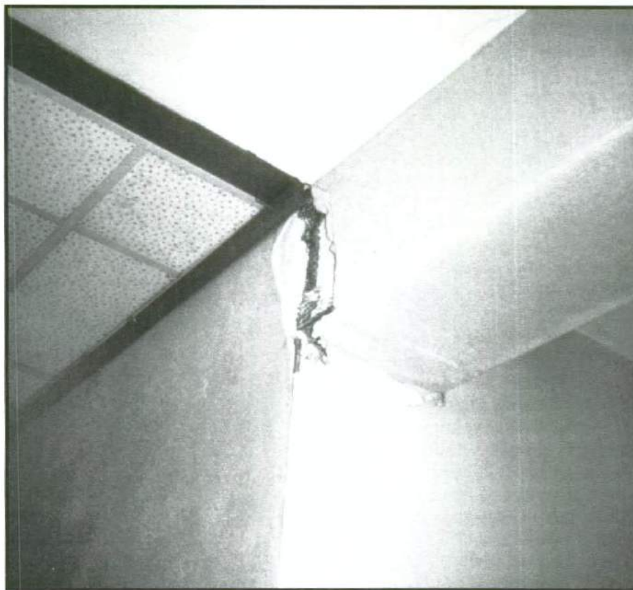
Figura 33: Grietas estructurales deben ser evaluadas por los ingenieros estructurales.
