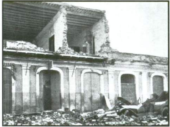
Figura 27: Daños durante el terremoto de 1918.
