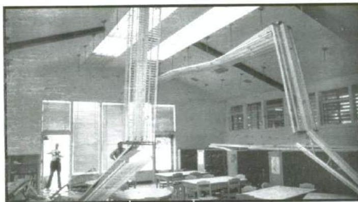
Figura 38: Elementos no estructurales como las limpiezas de techo pueden caer durante un temblor.
