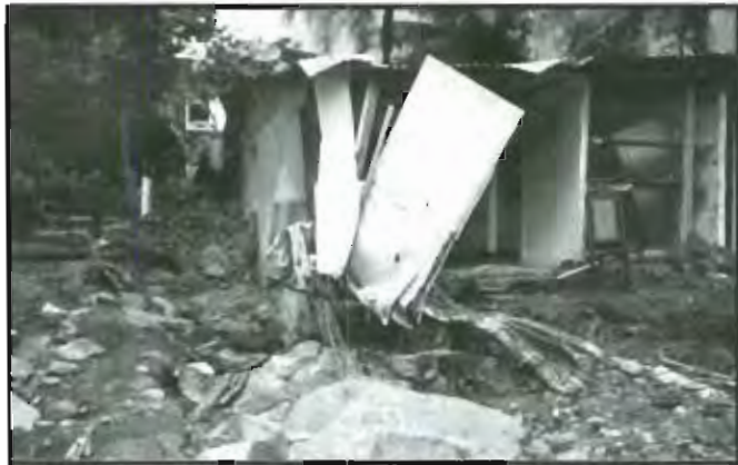
Figura 11: Daños provocados por las inundaciones del huracán Hortense (1996) en Guayama.
