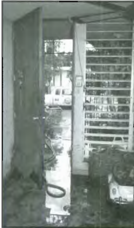
Figura 27: Daños producidos por el agua dentro de la residencia.
