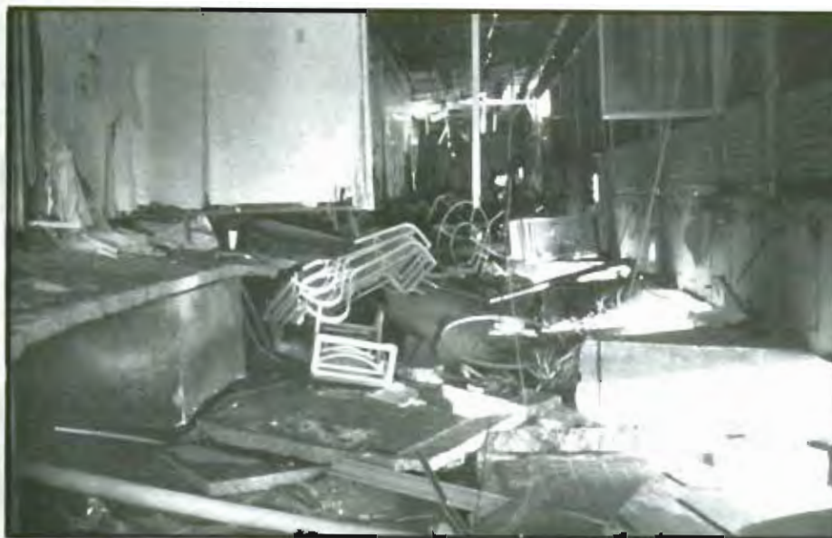
Figura 62: Interior devastado por las inundaciones.
